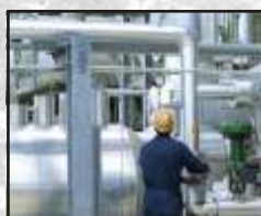
Isolamento térmico em instalações frigoríficas
