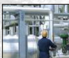
Isolamento térmico em instalações frigoríficas
