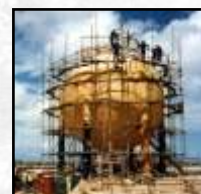
Isolamento térmico em pólo petroquímico
