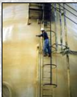
Tanques de óleo
